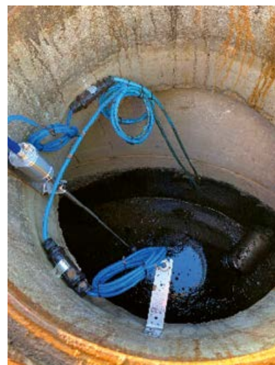
Abb. 5: Einbausituation in einem Einstiegschacht; links im Bild der Sensor für die Leichtflüssigkeitsschichtdicke und unten der Haltewinkel für den Schlammpegelsensor; der Schlammpegelsensor selbst befindet sich unter der Flüssigkeitsoberfläche.
